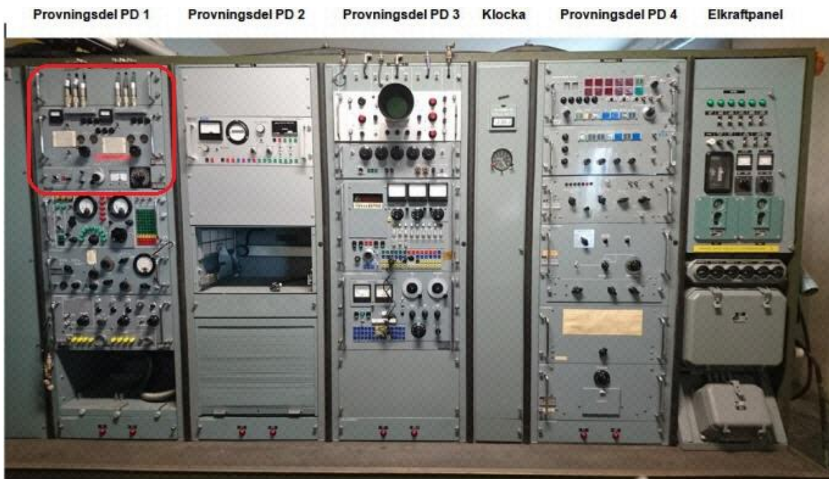
På Provningsdel PD 1 i Servicebussen (vänstra delen)
