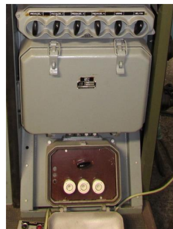
Kraftpanel nedre delen
