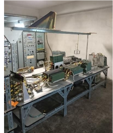
Bakre delen av riggen
