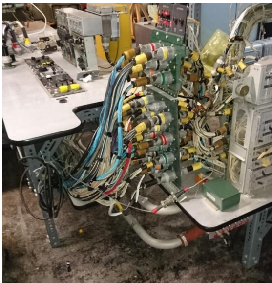
Skarvdon V20 mellan kabinen och främre apparatrummet
