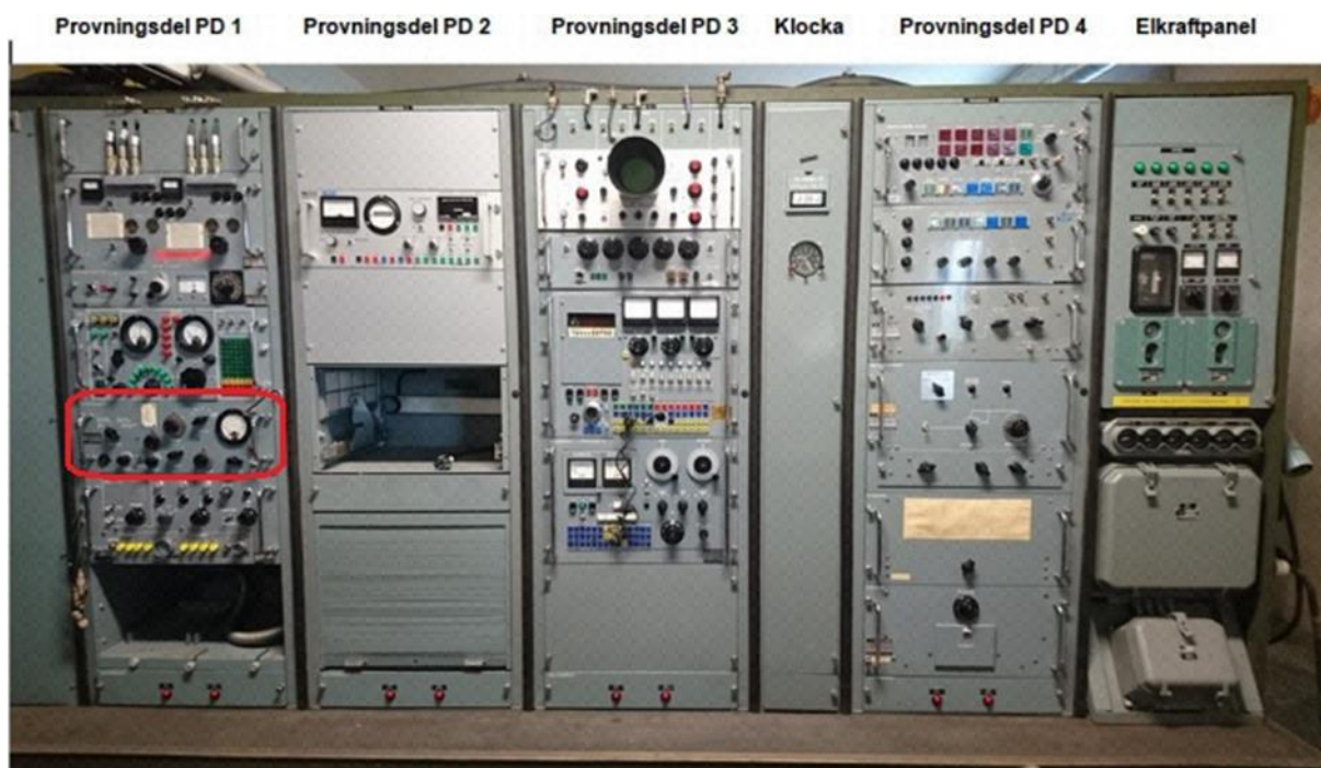
På Provningsdel PD 1 i Servicebussen (vänstra delen)
