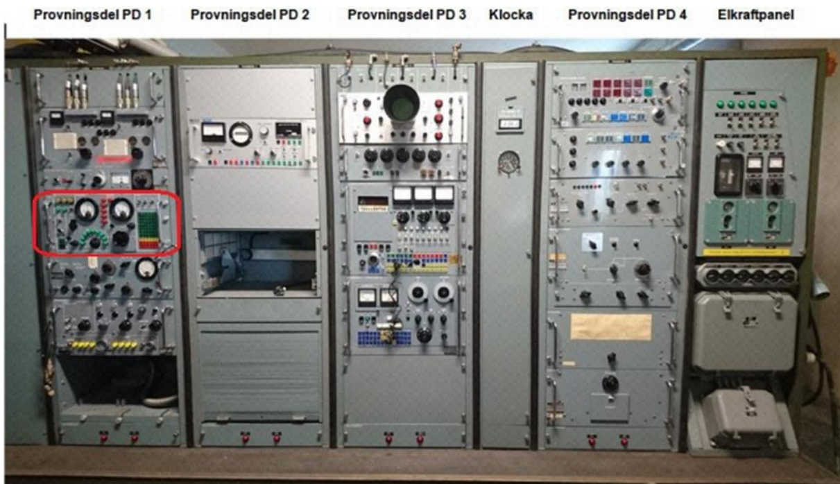
På Provningsdel PD 1 i Servicebussen (vänstra delen)
